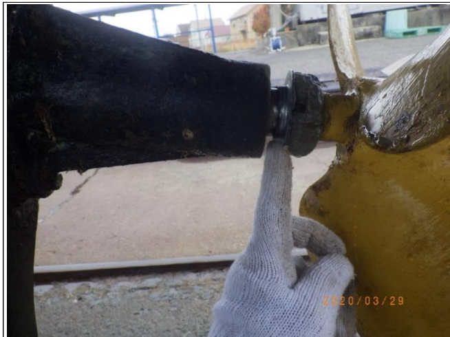
5 リング垂鉛端面が接触し摩耗している(約15mm移動)
